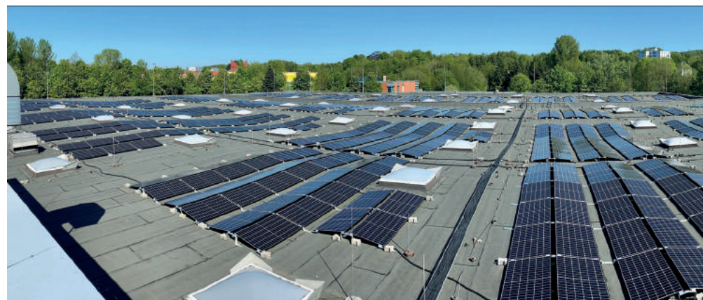
Die Photovoltaikanlage auf den Wagenhallen und die LED-Beleuchtungsanlage an den Werkstattarbeitsplätzen sind ein wichtiger Bestandteil des Energiekonzeptes der VER zur Reduzierung von CO 2 .
